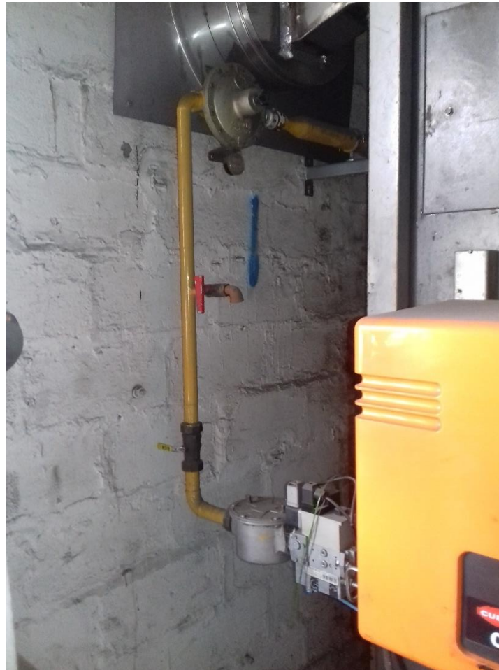
Figure 9 : Vue du secteur E - Chaudière n°1
