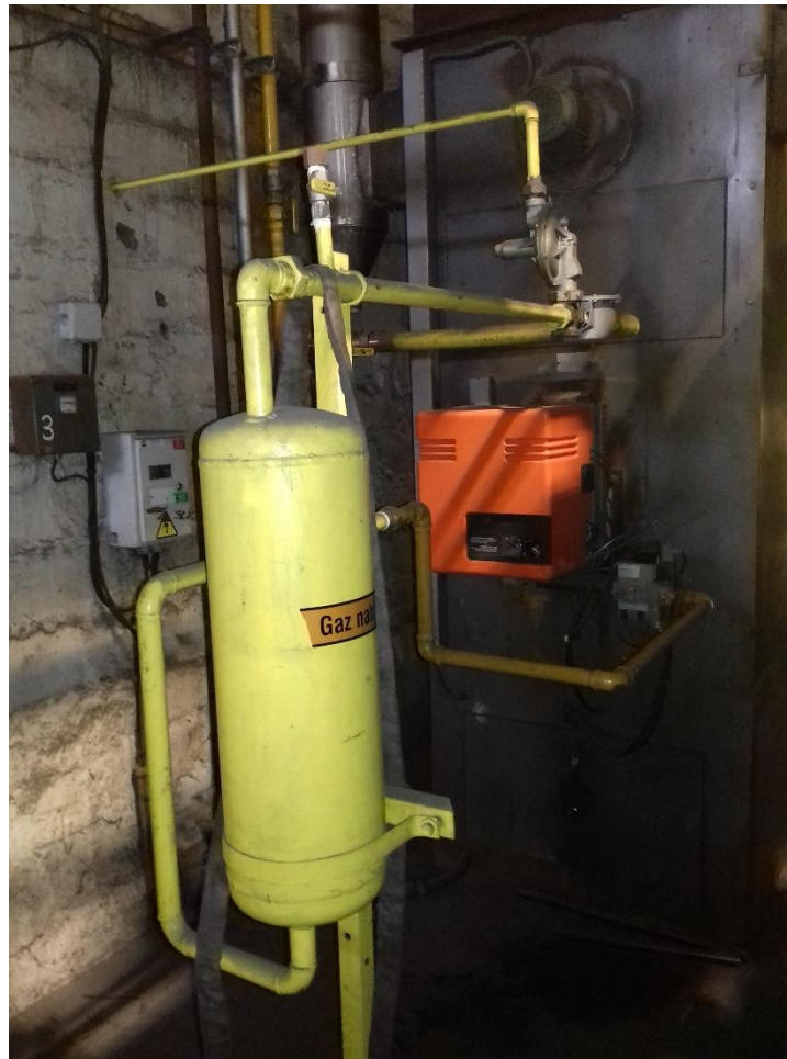
Figure 6 : Vue du secteur B - Chaudière n°2
